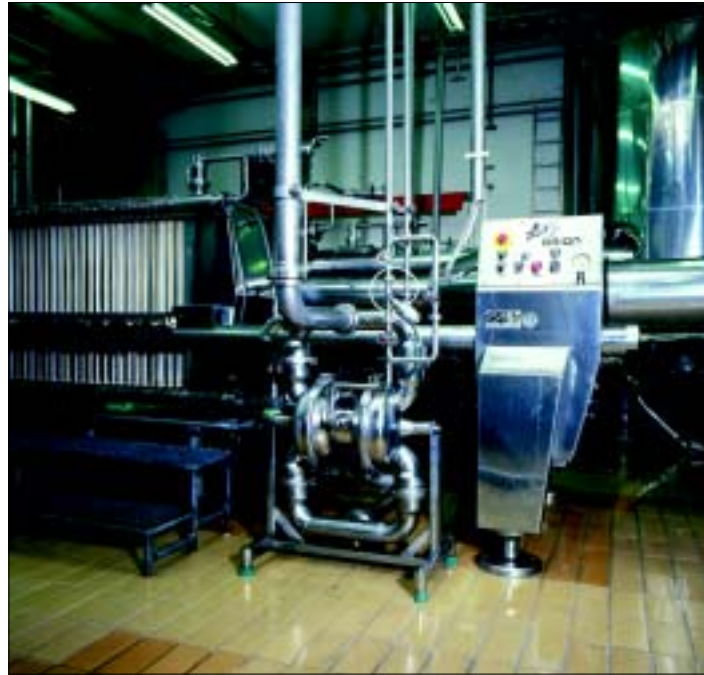
Abb. 1: Sauber und hygienisch unbedenklich - so sieht es nicht in jedem Abfüllbetrieb der Getränkeindustrie aus. (Foto: Crane Process Flow Technologies GmbH, Düsseldorf)
