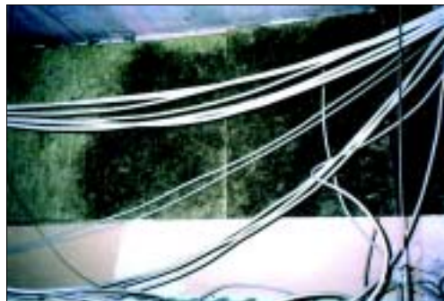
Abb. 2: Typischer Befall mit Schimmelpilzen in einem Industriebetrieb (Foto: NovaBiotec Dr. Fechter GmbH, Berlin)
